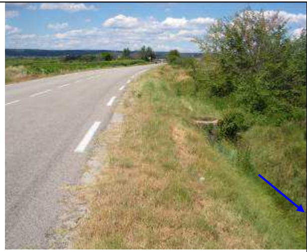
Photo 2 : Fossé pluvial de la RD 192
