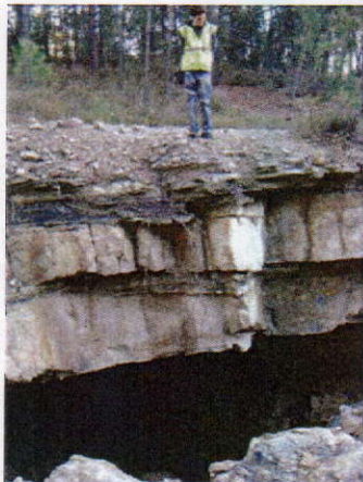
⇒ entrée de galerie → mesure de mise en sécurité
