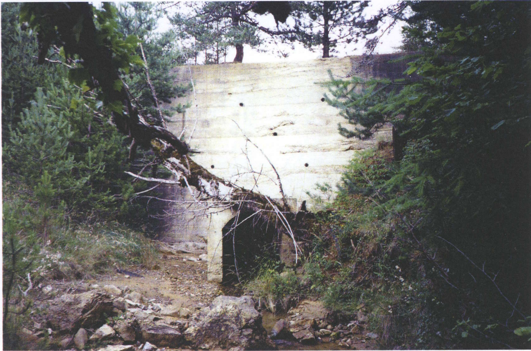
Mur de soutènement de la digue basse et débouché du collecteur souterrain
