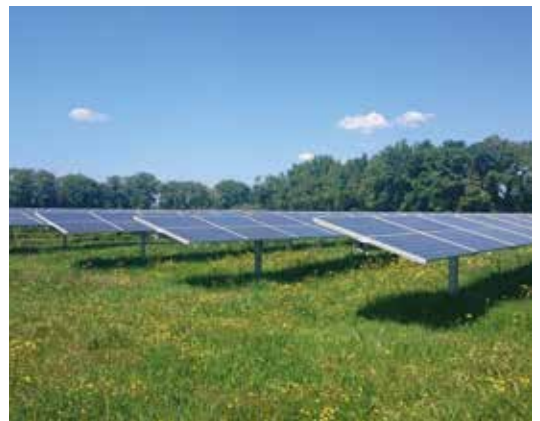
Parc photovoltaïque Arkolia Énergies Le Soler
